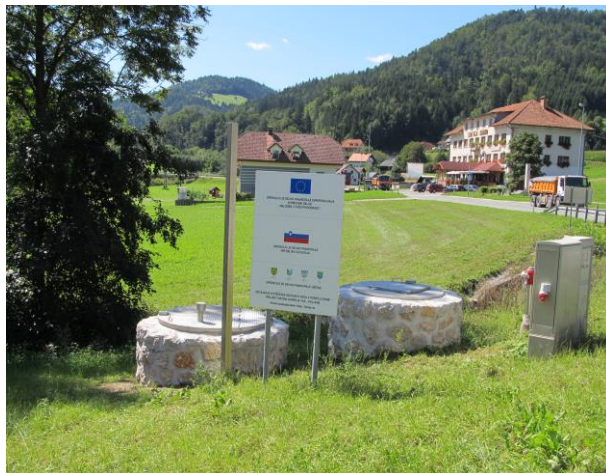
Črpališče komunalnih odpadnih voda Trebija 1.
