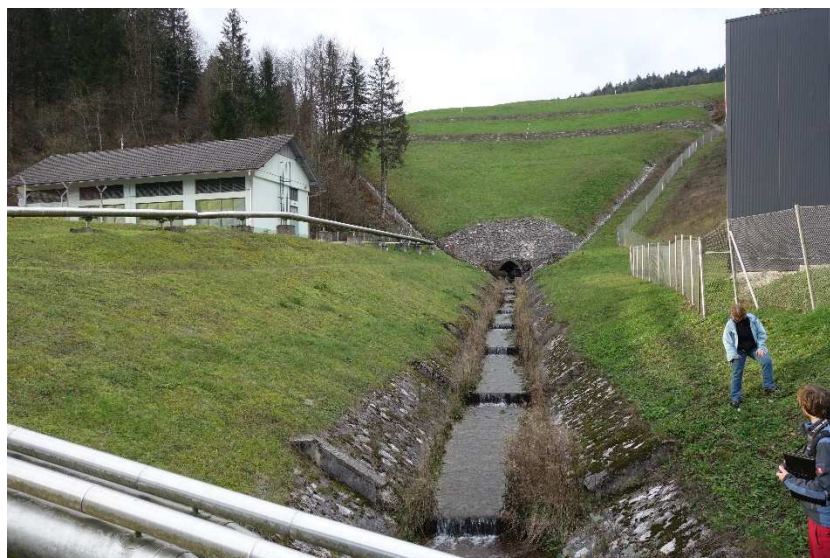
Slika 2: Pregled stanja ob kanalu Jazbec.
