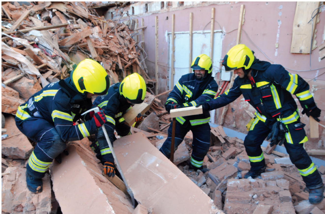
Gasilci med ruševinami kulturnega doma
