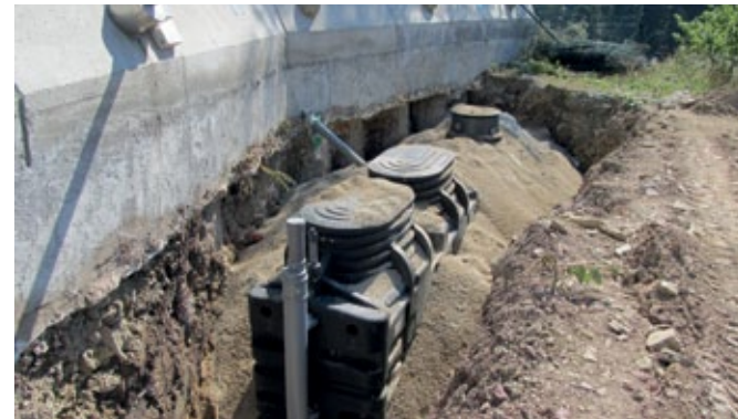
Mala komunalna čistilna naprava pri PS Sovodenj
