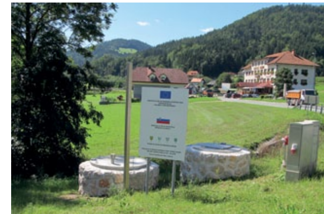
Črpalšče komunalnih odpadnih voda Trebija 1
