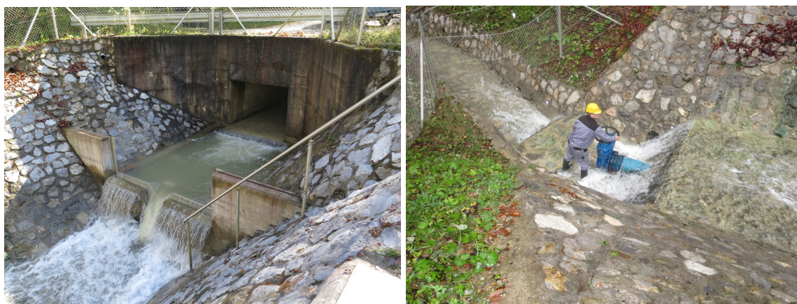
Slika 19: Merilno mesto BPG dne 22. 10. 2014 po intenzivnih padavinah zasuto s sedimentom (levo), odpiranje izpustnega ventila ob čiščenju sedimentov merilnega mesta (desno)
