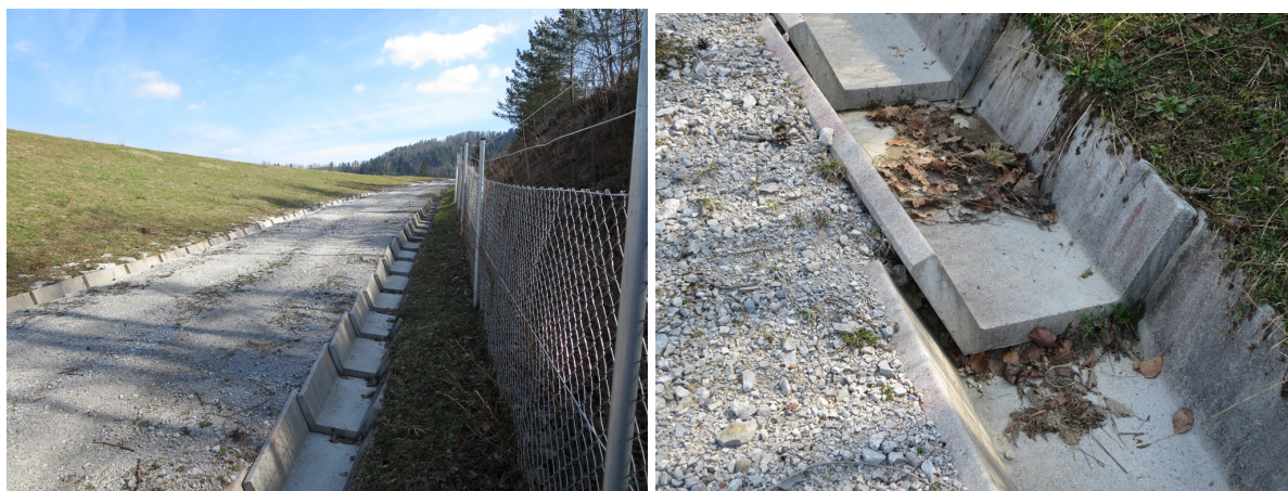
Slika 4: Zgornja cesta na odlagališču Boršt, mesto posedka ceste (levo), zamik kanalet (desno)
