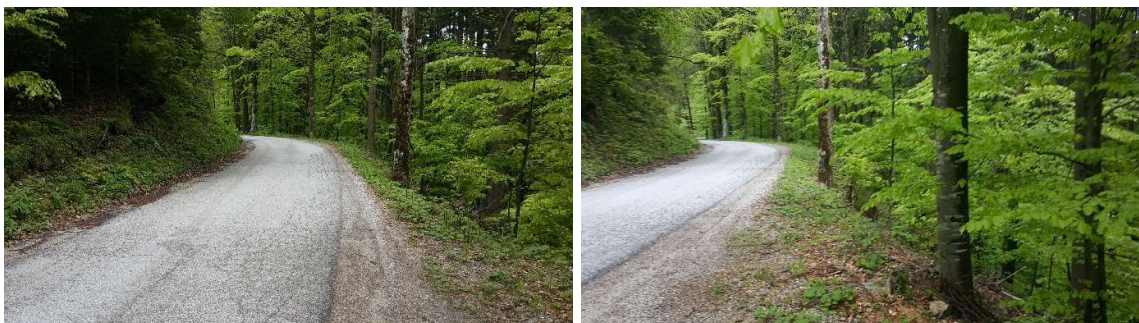
FOTO 1 in 2: Posedanje zunanjega dela cestišča v km 1.860
