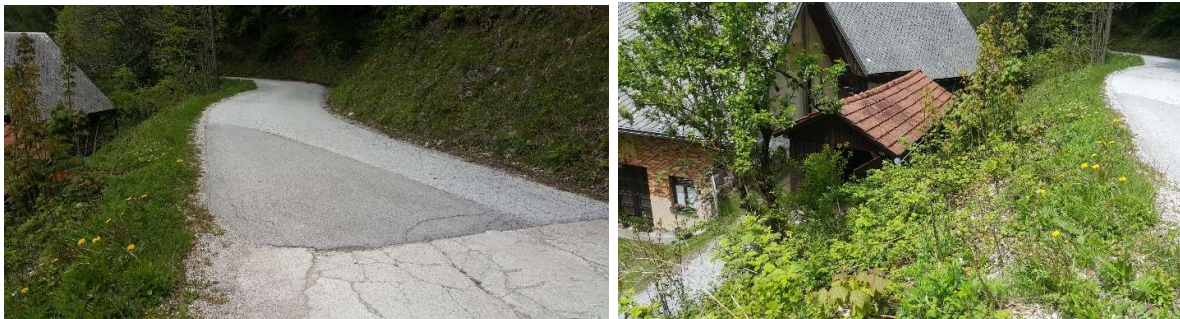
FOTO 3 in 4: Posedanje zunanjega dela cestišča v km 2.030, nad HŠ Dolenja Žetina 1
