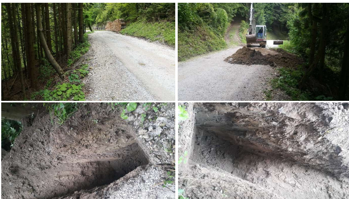
FOTO 15-18: Območje plazu 2 in sondažni jašek SJ-2, ki je dosegel podlago na 3,7 m
