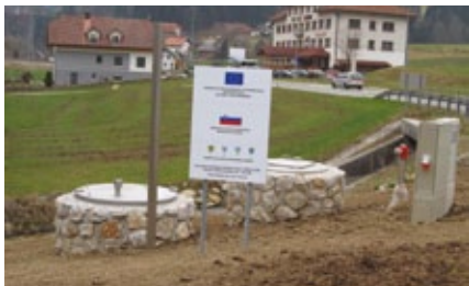
Črpališče komunalnih odpadnih voda Trebija-1
