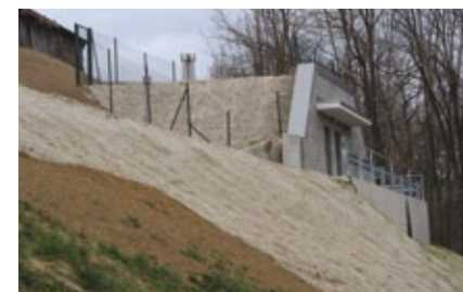
Novi vodohran Kovnica (100 m 3 )
