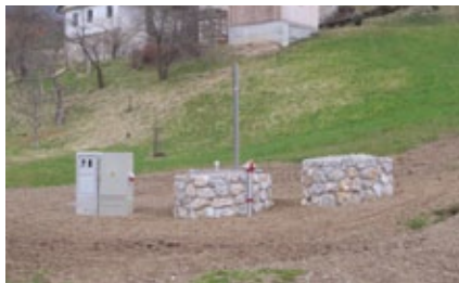
Črpališče komunalnih odpadnih voda Trebija-2
