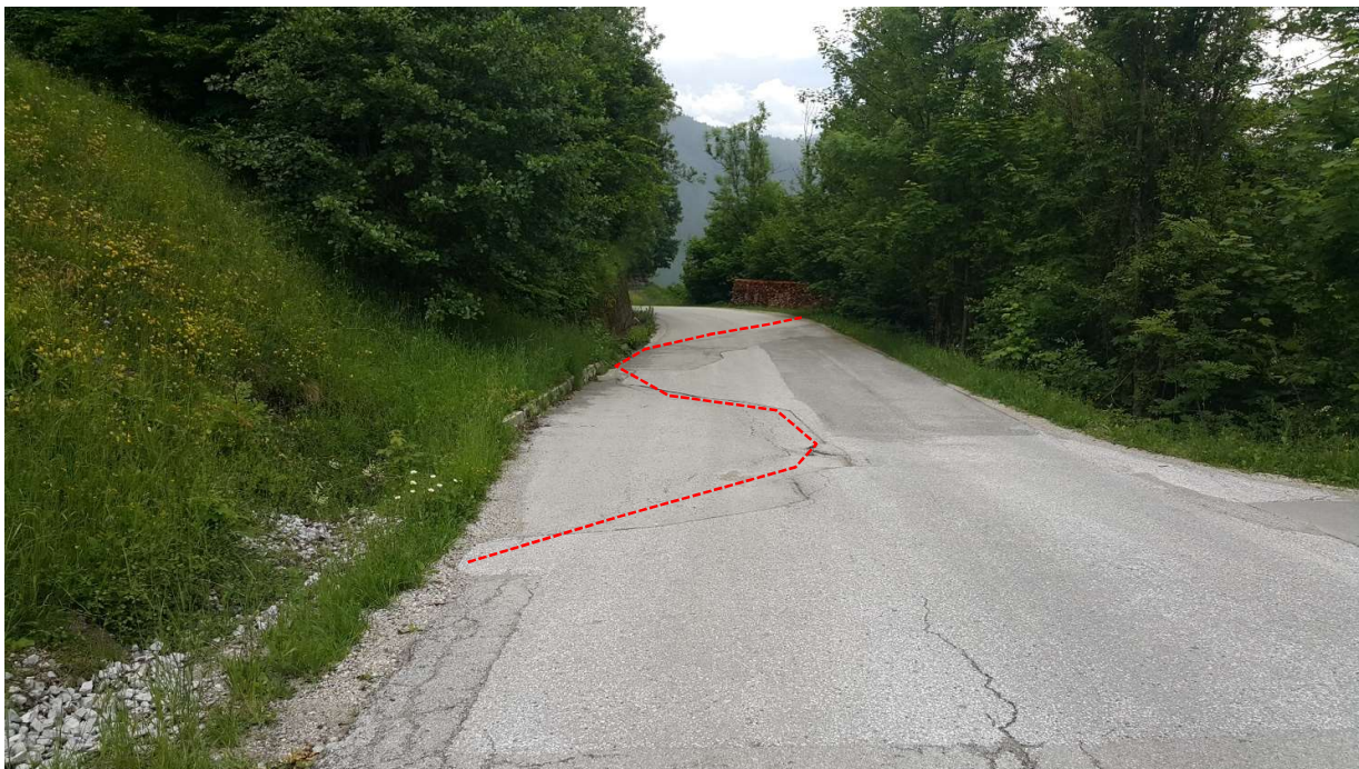
FOTO 4: Plaz 2 in vidni odlomi ob katerih je cesta posedena do 20 cm
