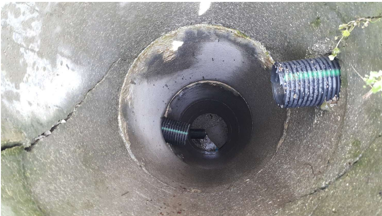
FOTO 9: Revizijski jašek globine 5,0 m. Zgornja cev je poškodovana zaradi trka avtomobila (po pričevanju domačina). Deluje le spodnja drenaža. Jašek v vertikalni smeri ne odstopa.
