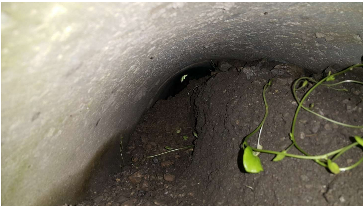
FOTO 8: Plaz 4. Poškodovan in zamašen prepust. Voda odteka v cestni nasip in pospešuje plazenje.
